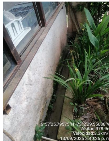
Fotografía 8. Canal por donde sale el agua a la parte externa del predio
