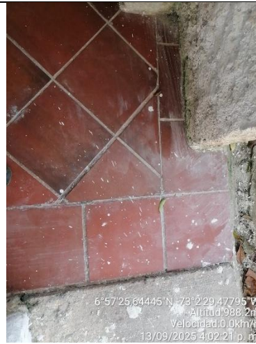
Fotografía 6. Rastros de pintura en suelo
