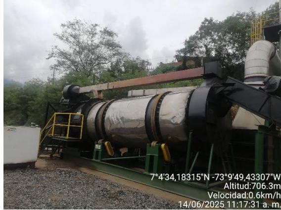
Fotografía 6. Tambor de calentamiento
