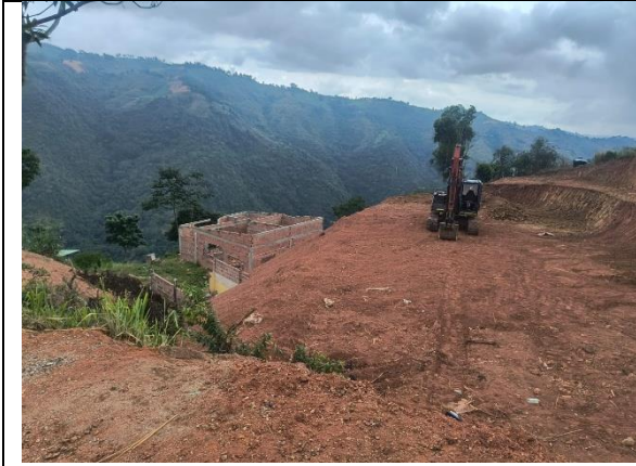
Fotografía 3. Terraza y vivienda con problemas estructurales.
