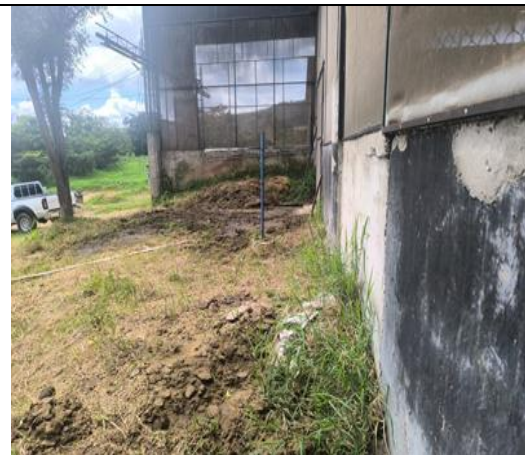
Fotografía 2. Cajas en concreto que presentan reboso de heces fecales en el suelo
