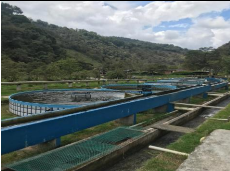
Fotografía 7. Estanques en geomembrana ubicados en franja de protección del Río Manco.
