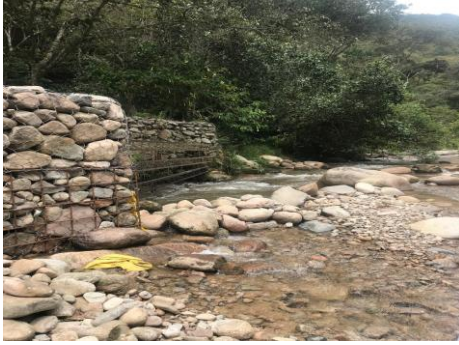
Fotografía 3. Magnitud de la construcción de 3 gaviones aproximadamente de 2m de ancho x 1m de alto cada uno.
