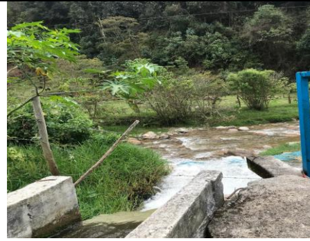
Fotografía 10. Canal a través del cual se descarga al Río Manco.
