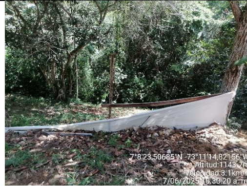
Fotografía 14. Medida de contención material de excavación en parte baja del predio paralela a la terraza 3
