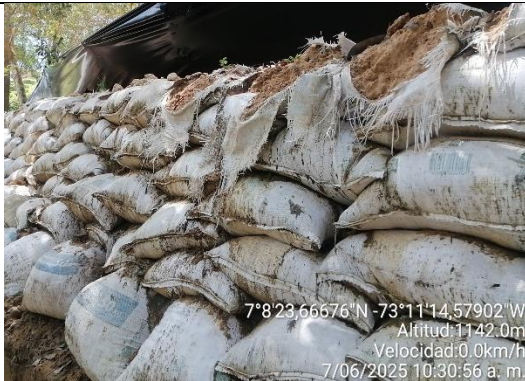
Fotografía 11. Contención sobre corte de la terraza 3 con muro en sacos de suelo apilados deteriorados
