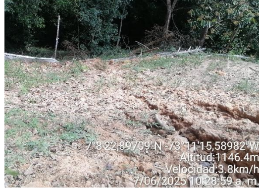
Fotografía 8. Surcos en material dispuesto generados por escorrentía del agua
