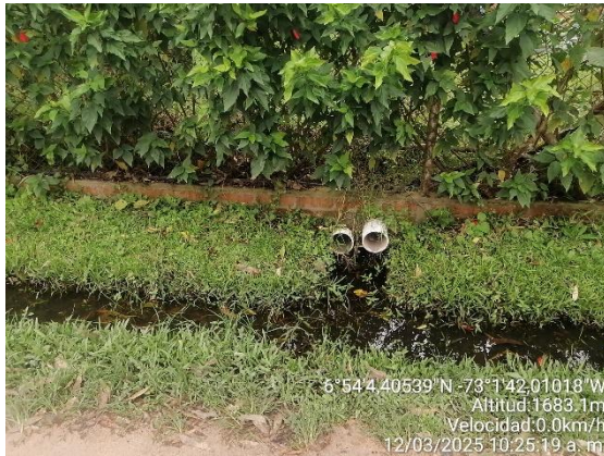
Fotografía 5. Salida de aguas lluvias del conjunto residencial Altamira 7 a zanja externa en la vía
