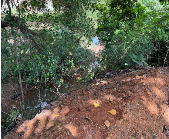
Fotografía 5: Relleno hasta el borde de fuente hídrica
