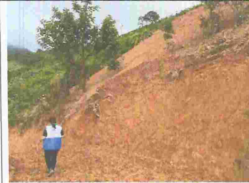
Fotografía No. 7. Material dispuesto sin medidas de control y/o contención.
