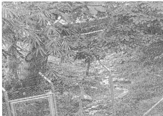
Fotografía 2. Instalación de gaviones parte trasera del predio Club Hotel Bar Barlovento del municipio de Piedecuesta.
