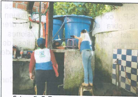
Fotografía 7. Tanque para recolección de aguas lluvias.
