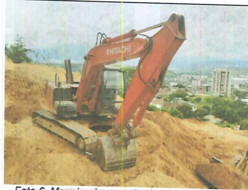
Foto 6. Maquinaria encontrada al momento de la inspección ocular.
