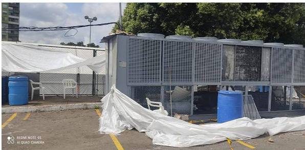
Fotografía 1. Máquina enfriadora para pista patinaje.
