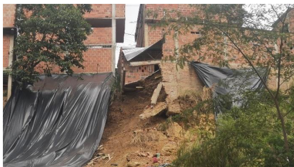
Movimiento en masa. Asentamiento Asomiflor, municipio de Floridablanca. Fuente Propia.
