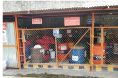
Ilustración 11 Área de transferencia de residuos sólidos, aceites y residuos especiales generados en la empresa Rambal S.A.S.
